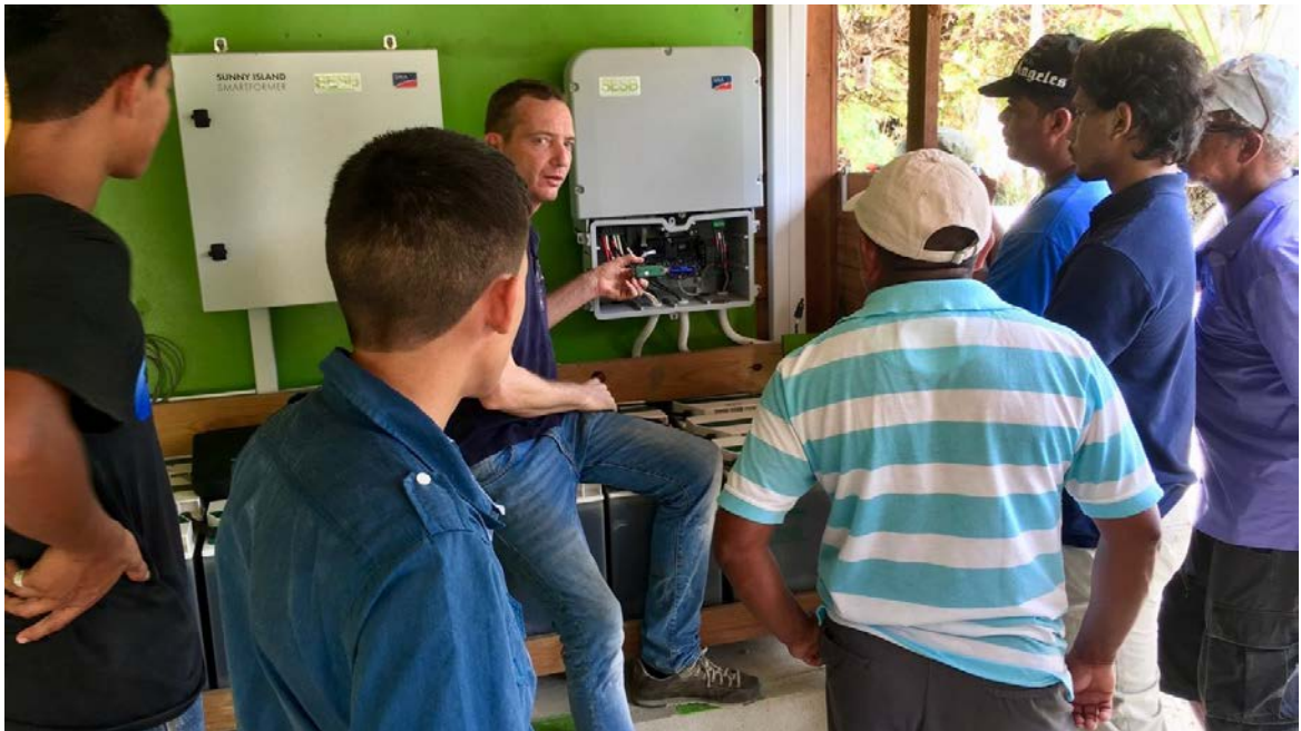
Abbildung 9: Das Innere eines Wechselrichters wird beschrieben (Bild: SESB)
