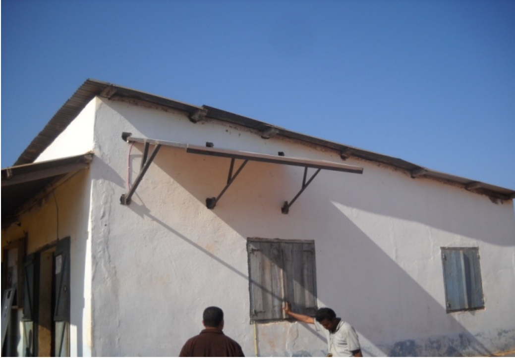
Solaranlage Fassade Bürgermeisteramt im Dorf Beahitse (District of Ampanihy)
