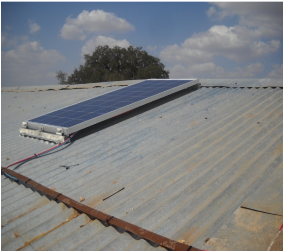
Solaranlage auf Grundschule im Dorf Beahitse (District of Ampanihy)
