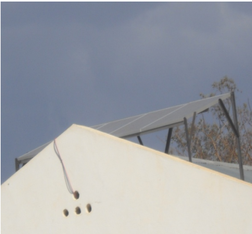
Solaranlage Gesundheitszentrum im Dorf Beahitse (District of Ampanihy)
