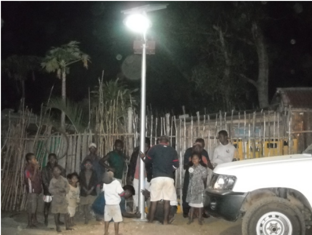
Solarlampe zur Strassenbeleuchtung im Dorf Beahitse (District of Ampanihy)
