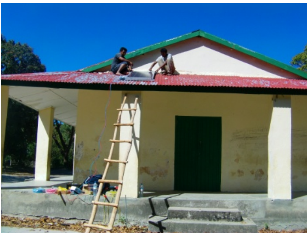
Solaranlage auf Grundschule im Dorf Soanierana (District of Fort Dauphin)
