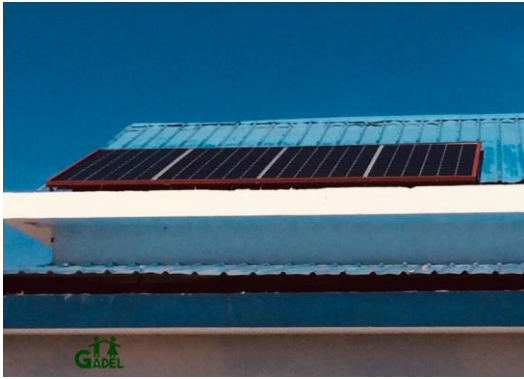
Bild 12: Solaranlage auf dem Schulgebäude
