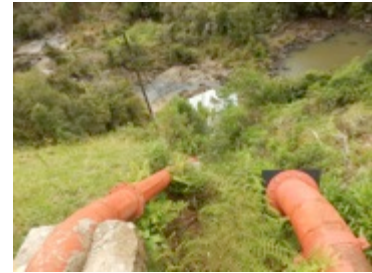
La conduite forcée fonctionnelle à gauche qui se rend à la centrale et à droite celle détruite par le cyclône
