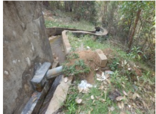
Le canal principal se rend dans la direction des rizières. Vers la droite, a été aménagée la conduite forcée qui sépare l'eau et en amène une partie à la centrale hydroélectrique.
