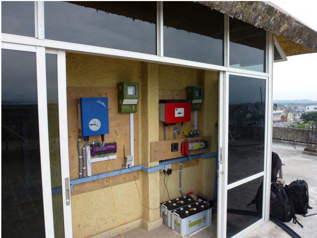
Figura 12: Ondulatori e contatori di energia, batterie di backup e sistema di acquisizione dati degli impianti in P2.
