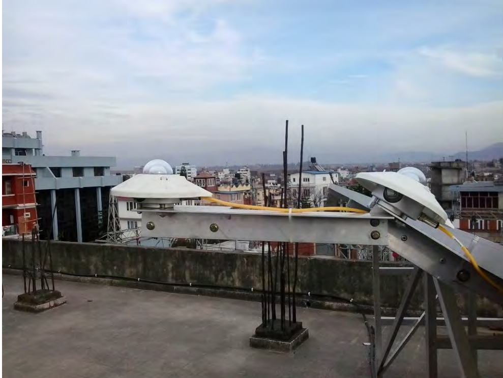
Figura 10: piranometro orizzontale e su piano inclinato sugli impianti in località P2.
