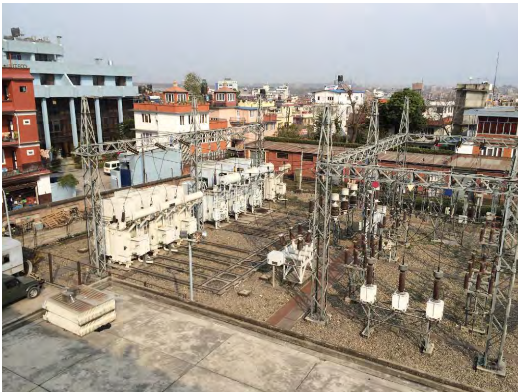
Figura 3: centro di distribuzione della Nepal Electricity Authority a Min Bhawan (P2).
