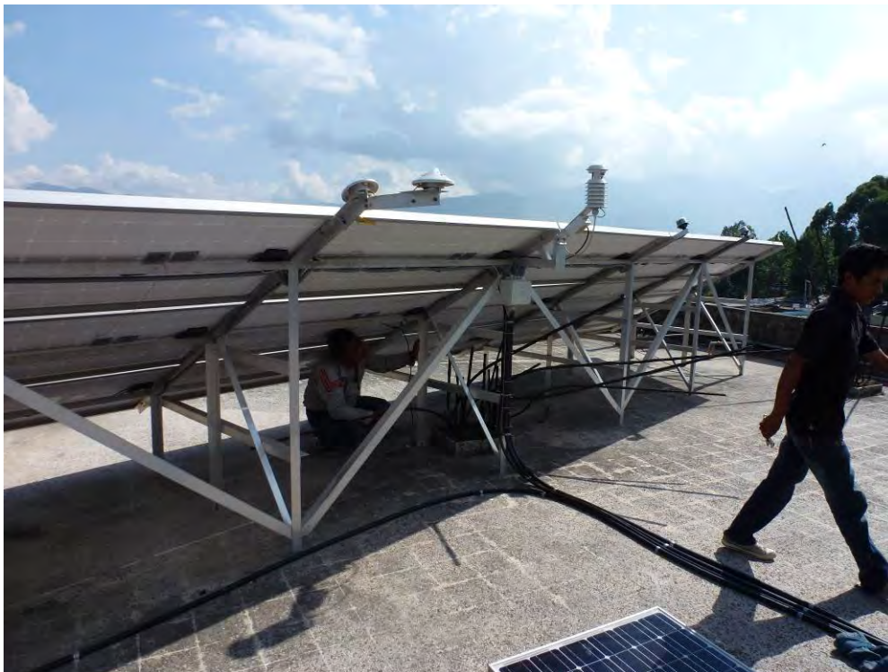
Figura 11: Array dei moduli solari LDK dell'impianto PV in P2.
