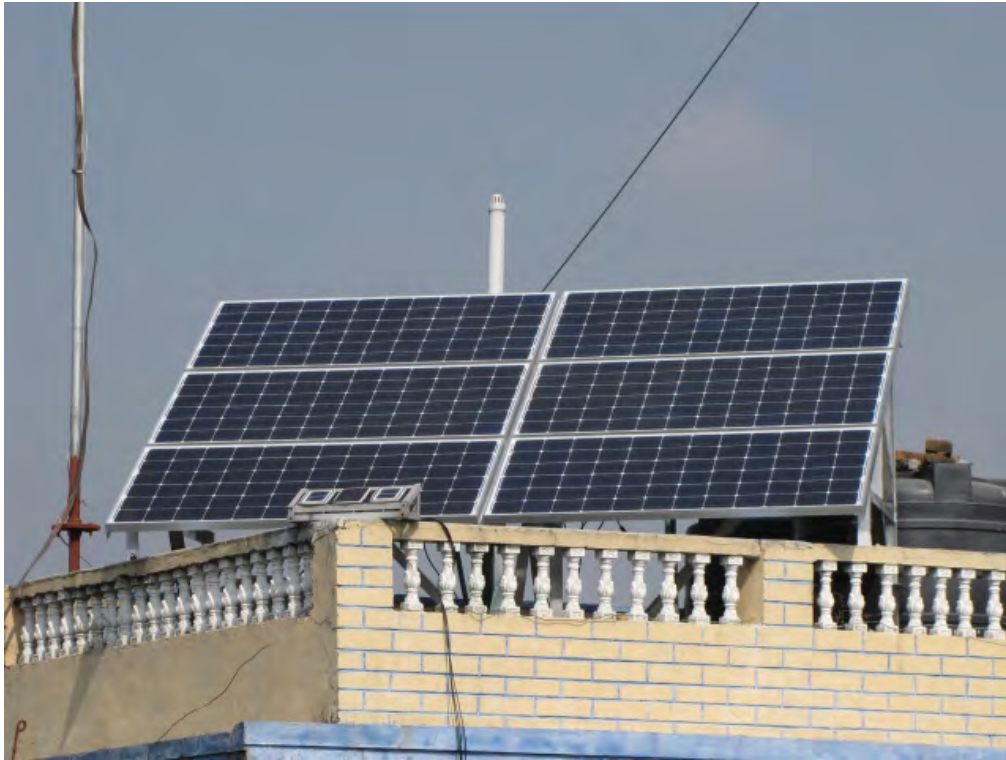
Figura 14: i 6 moduli PV posizionati sul tetto della sede RIDS-Nepal a Imadol, distretto di Lalitpur (P3).
