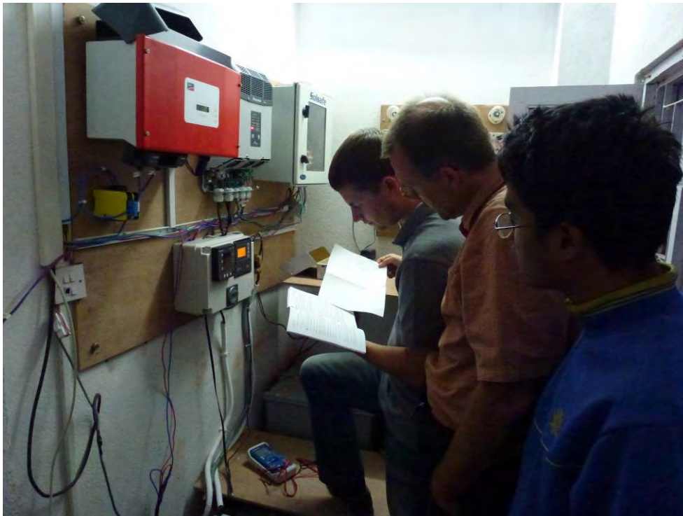
Figura 15: modifica dei setting dei parametri per il collegamento alla rete dell'ondulatore fotovoltaico e dell'ondulatore bidirezionale di batteria (P3).
