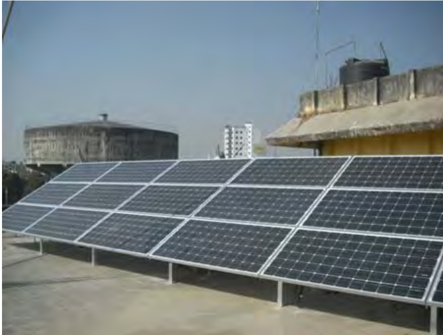
Figura 8: i tre campi fotovoltaici da 1.1 kWp sopra gli uffici della NEA (Nepal Energy Authority) a Min Bhawan (P2).
