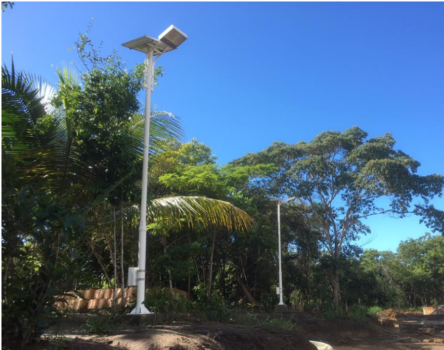
Abb. 10: Solarlampen beim Einfahrt in die Schule
