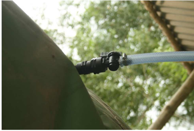
Vanne en sortie de gazomètre
