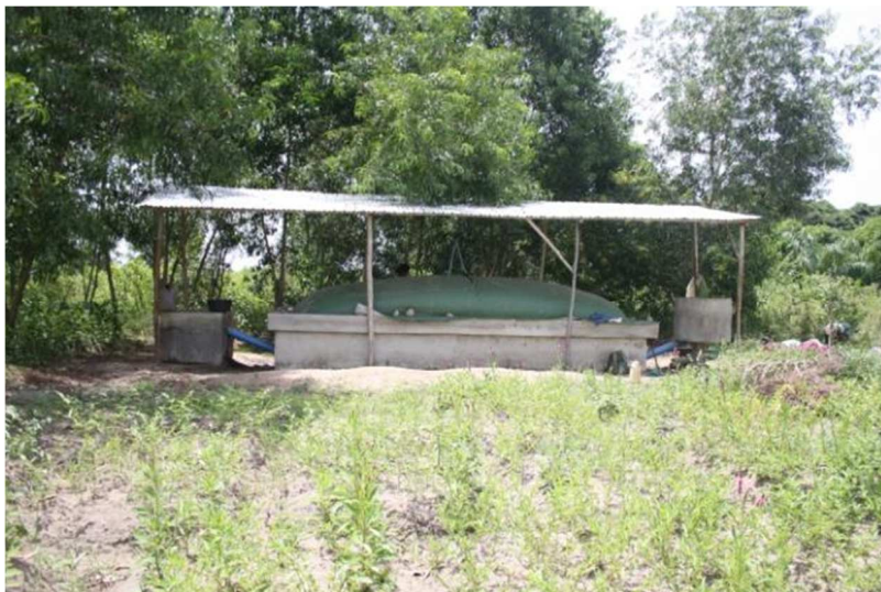
Installation de méthanisation
