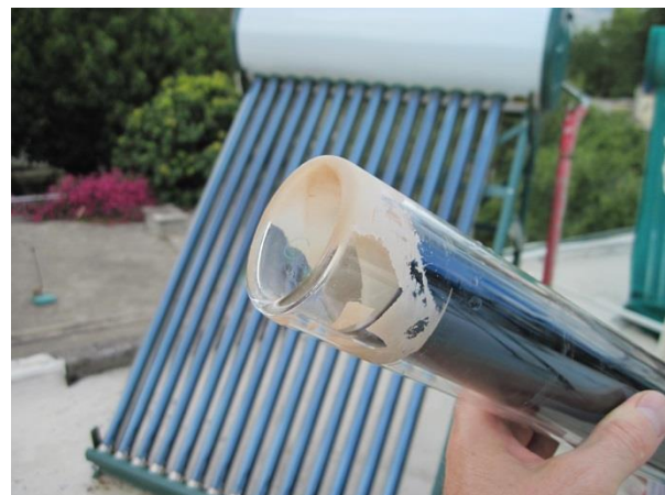
Abbildung 2: Verkalkung bei direkt durchflossenen Vakuumröhren von drucklosen Thermosiphonsolaranlagen innerhalb 6 Monate.
