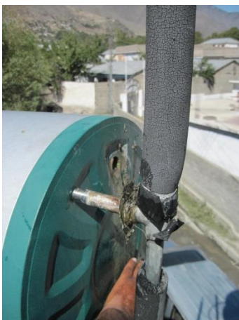
Abbildung 1: Undichte Anschlüsse einer drucklosen Thermosiphonsolaranlage.
