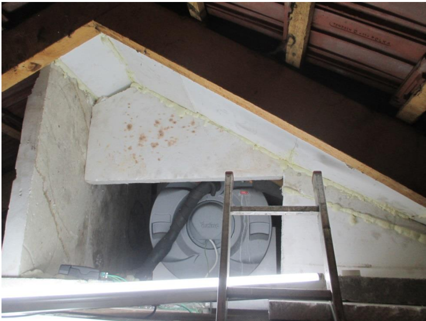
Abbildung 5: Speicher der Solaranlage eingebaut in 10 cm Polystyrol­dämmung.
