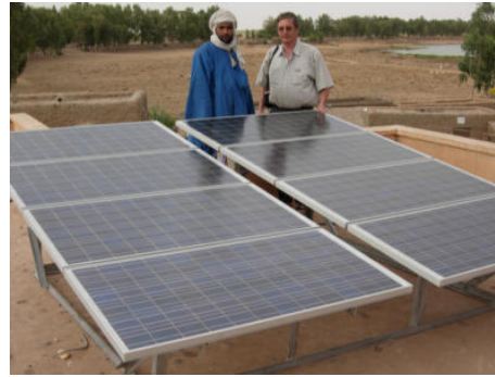
Die 8 x 100W/24V Solarmodule auf dem Dach des Marktes
