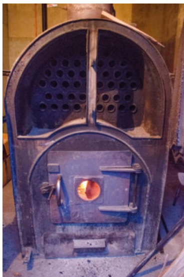
Der alte Holzspaltenkessel
