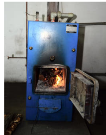
Holzspaltenkessel, bei Smog Betrieb verboten
