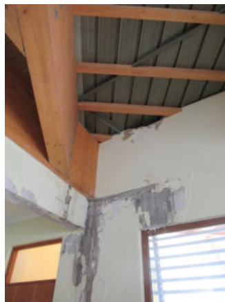
Undichte Anschlüsse an den vielfältigen komplizierten Stössen der Bauteile
