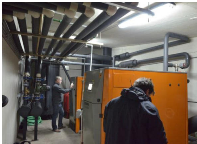
Erneuerte Holzsnitzelfeuerung mit Speicher
