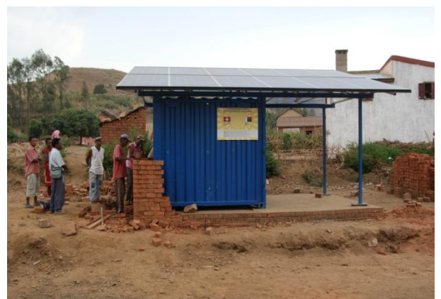
La centrale est raccordée au réseau souterrain. (le mur de protection est en construction)
