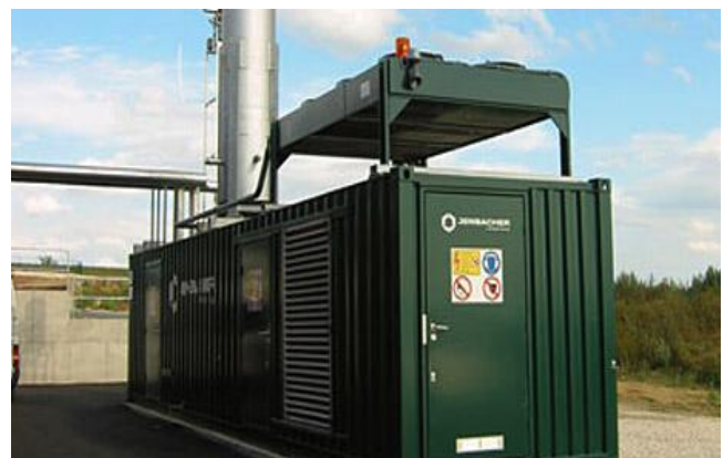
Abb.16: Container mit BHKW
