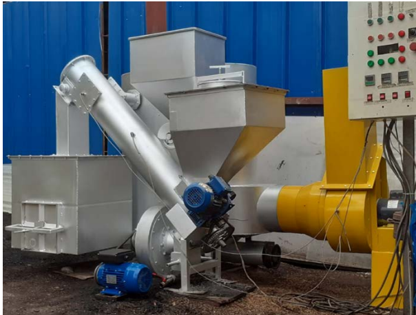
Abbildung 4: Finale Version der installierten Pyrolyse-Maschine PPV300
