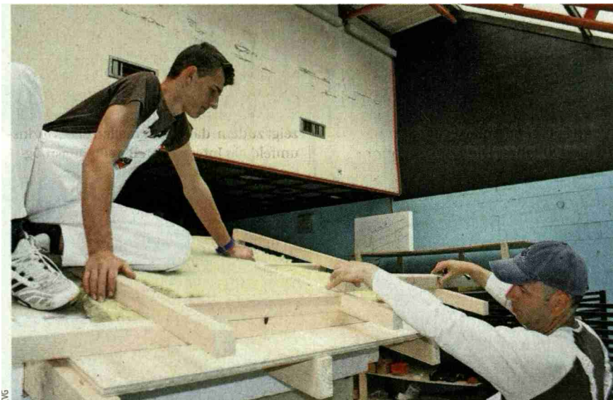
Praktisches Training nach Schweizer Vorbild: Zwei Studenten üben in Bosnien das richtige Dämmen von Gebäudefassaden und Dächern an einem Werkstattmodell.
